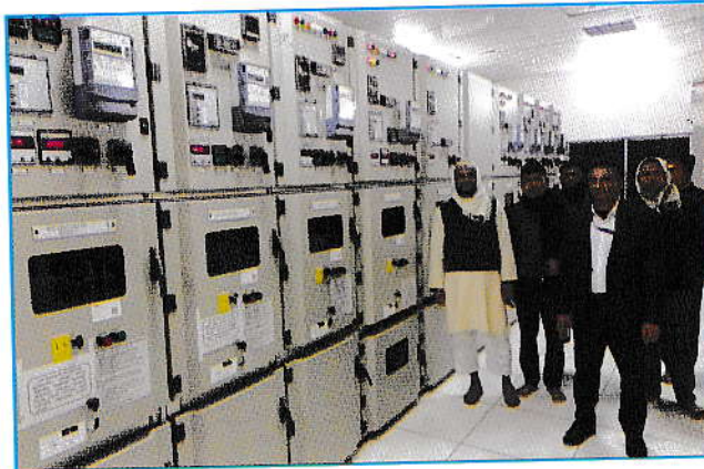
ইনডোর সাবস্টেশন পরিদর্শন করছেন সমিতির ডিজিএম (কারিগরী) ও এজিএম (ওএসএম)।
